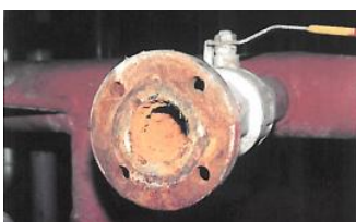
Problemas de la cal
