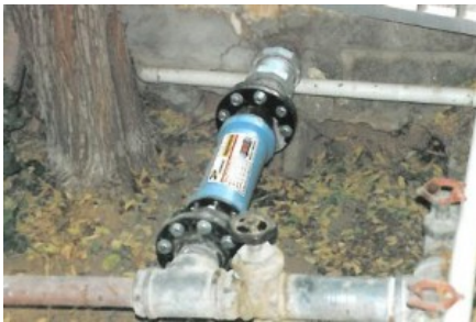
Instalaciones de riego
